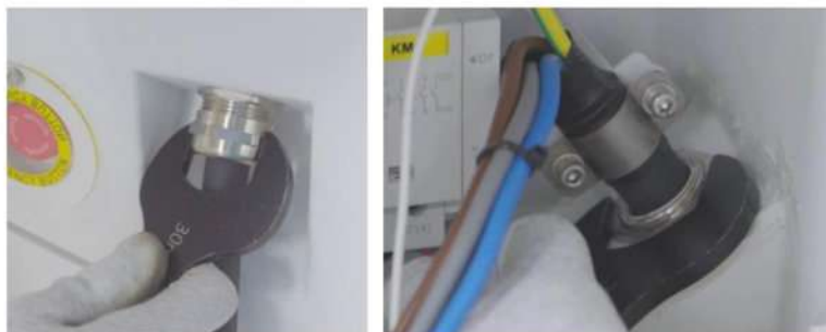
Figura 9-20 Extracción del prensaestopas manteniendo la tuerca interior fija.
